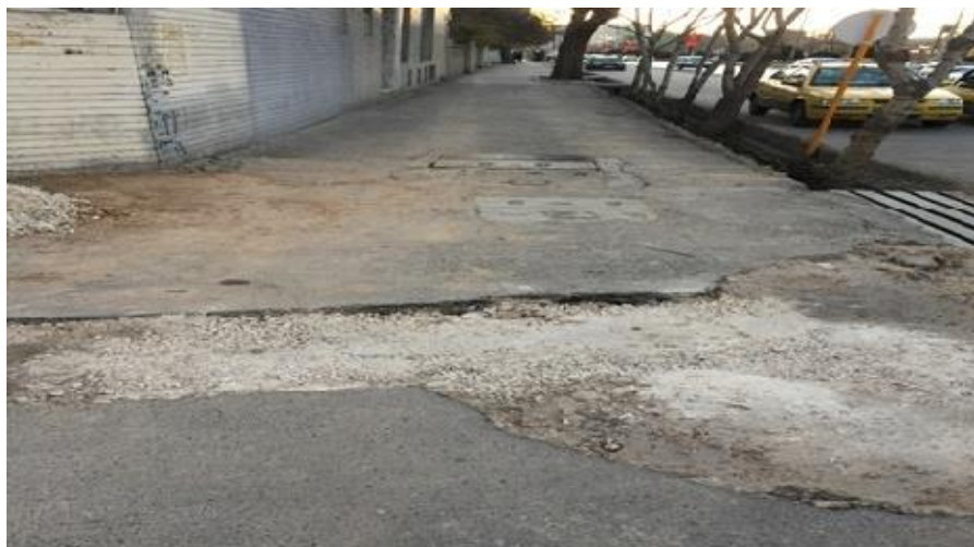
شکل ۹- قسمت هایی از مسیر که بدلیل عبور کابل‌های تاسیسات کنده شده
